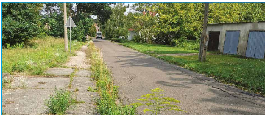
Hier könnte Hand angelegt werden für ein gepflegtes Straßen- und Wegebild im gesamten Landkreis.
